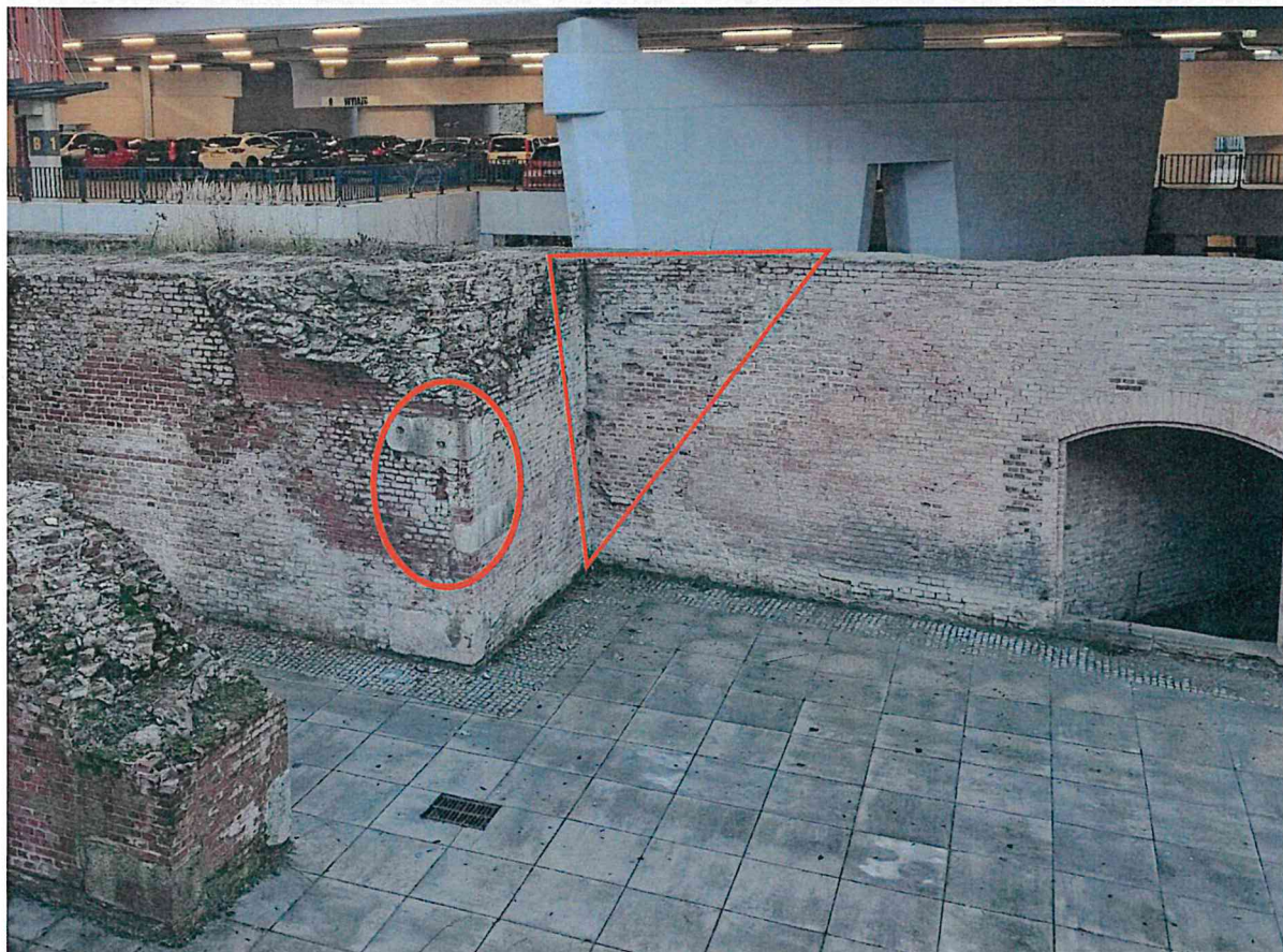
Rys. 13 Ślady przemurowań ściany dziedzińca kazamaty – opis w tekście.
