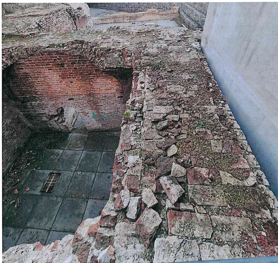
Rys. 26 Korona muru wartowni; widoczne całkowite odspojenie górnej warstwy cegieł oraz postępujące zawilgocenie muru nad wejściem, na posadzce materiał odspojony od ścian
