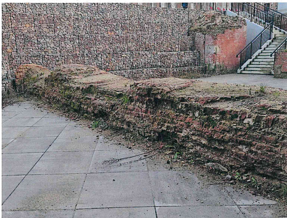
Rys.24 Mur strzelnicy; u podstawy muru pozostałości odspojonych przez działanie mrozu cegieł i zaprawy, daleko posunięta degradacja lica muru i jego korony
