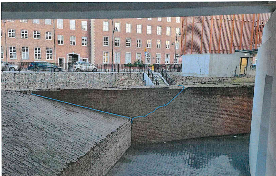
Rys. 18 Zasięg pęknięcia – wyraźnie widoczny zasięg pomiędzy poterną P i linii filarów kazamaty K
