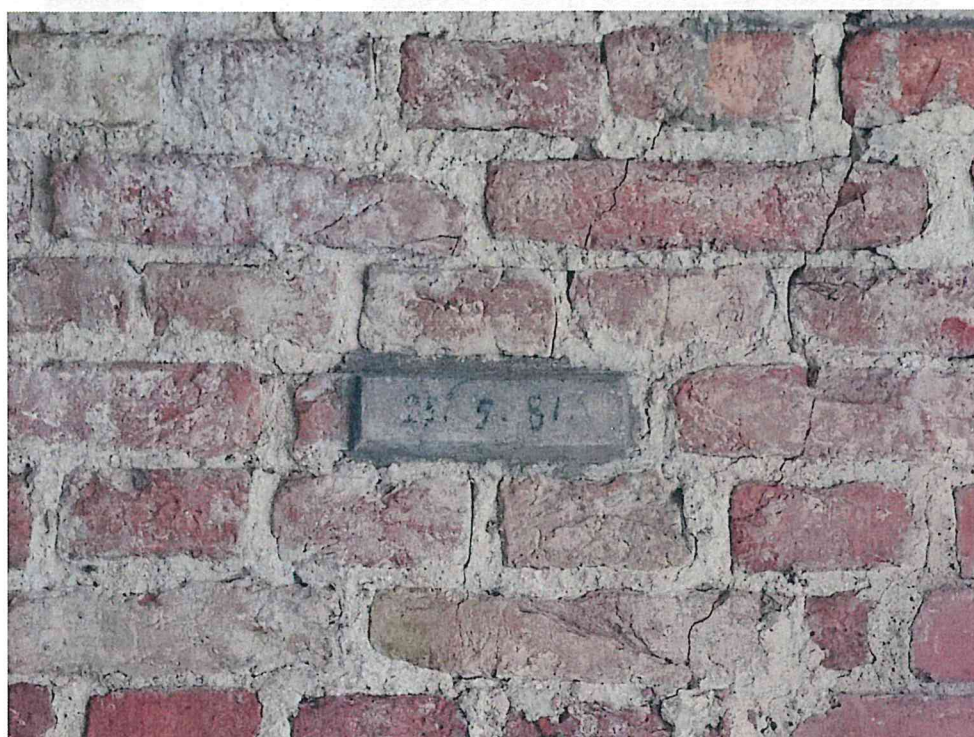
Rys.21 Marki kontrolne założone w maju 1881 roku – wskazują na brak propagacji rys od co najmniej 130 lat (górna fotografia - sklepienie poterny, dolna fotografia - ściana północna)
